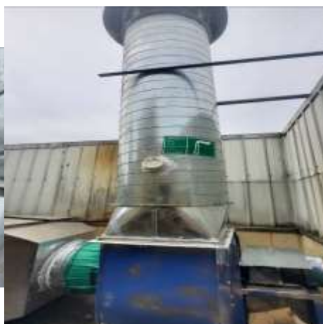
图 4.1-4 废气处理设施排气筒
