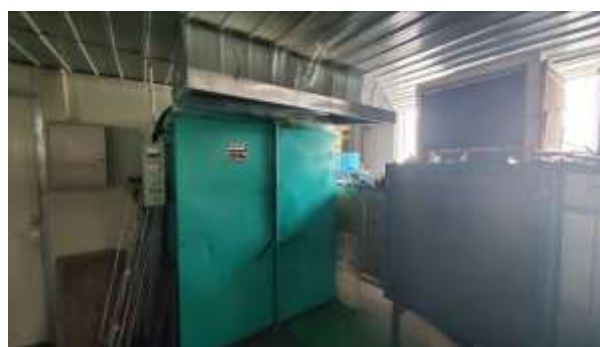
图 4.1-2 手工喷漆台烘干废气收集
