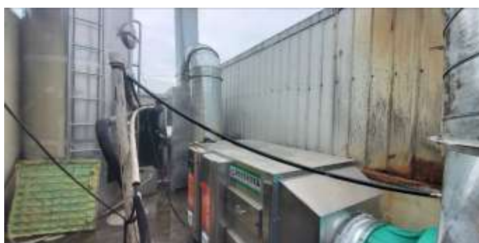
图 4.1-3 楼顶废气处理设施
