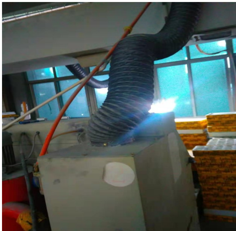
图 3-2 喷砂机自带的布袋除尘器
