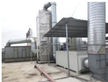
图 4.1-15 喷漆 3 喷漆废气处理
