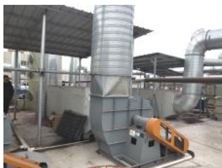
图 4.1-17 喷漆 3 固化线废气处理
