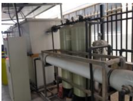
图 4.2-2 废水处理设施
