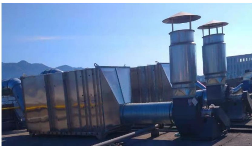
图 3-3 硫化废气处理设施
