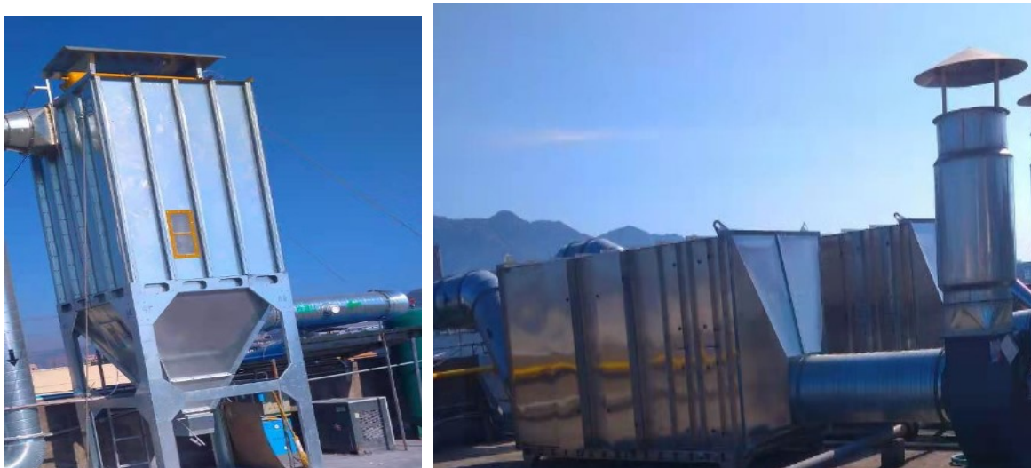
图 3-2 开炼废气、密炼废气处理设施
