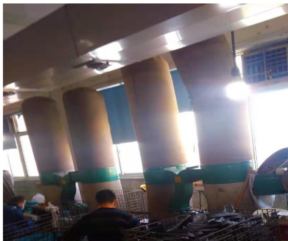
图 3-4 拉毛粉尘布袋除尘器
