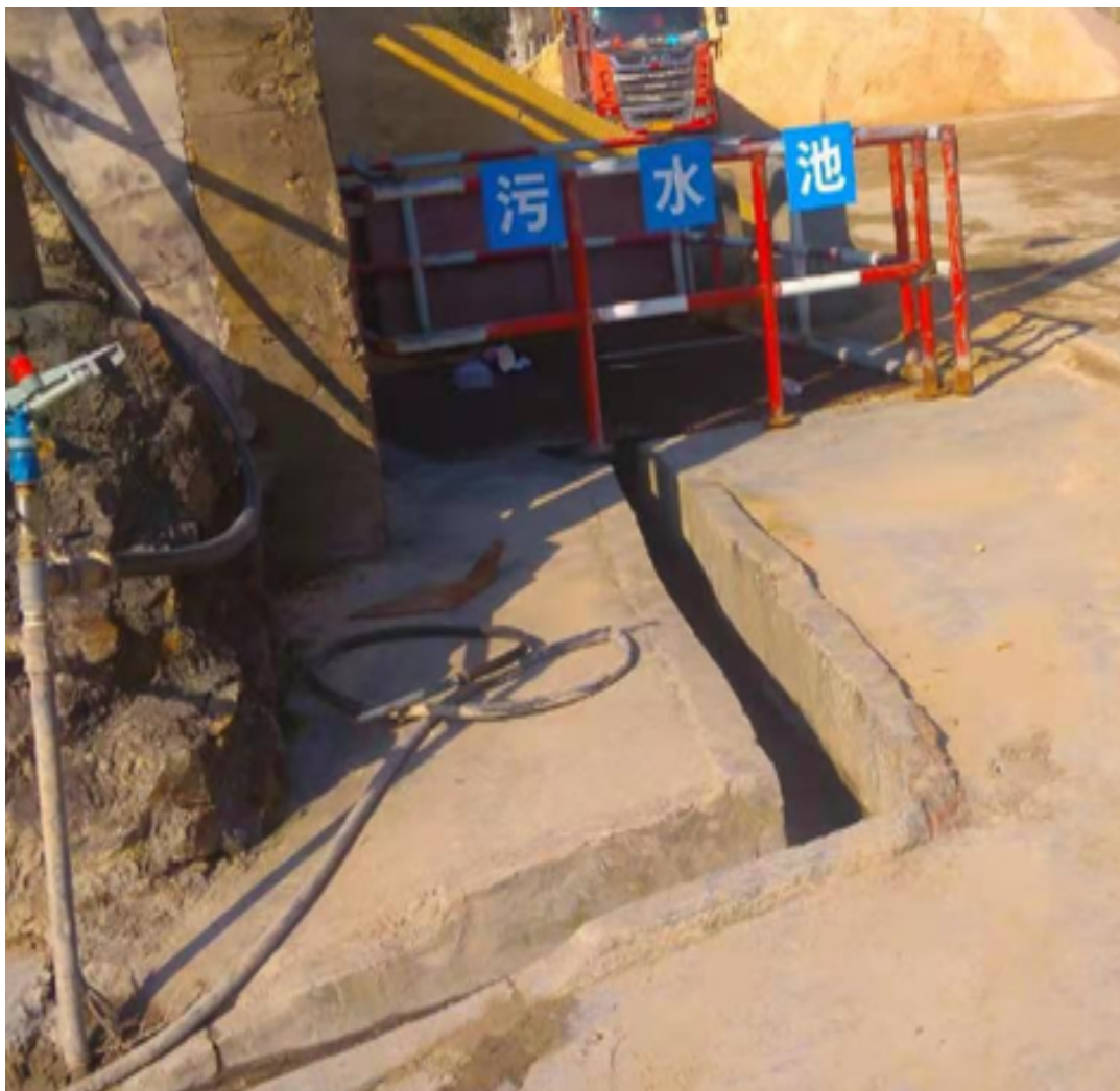
图 4-2 集水沟及污水池
