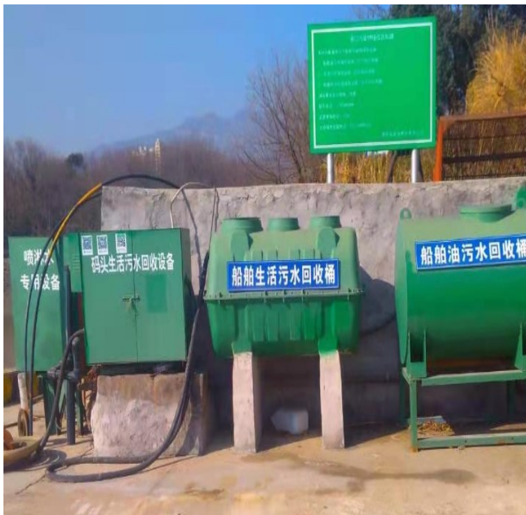
图 4-3 生活污水回收设备
