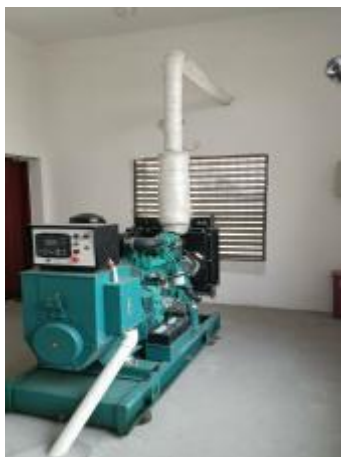
图 4.2-1 柴油发电机燃油废气排放
