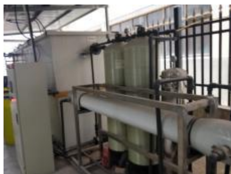
图 4.2-2 废水处理设施
