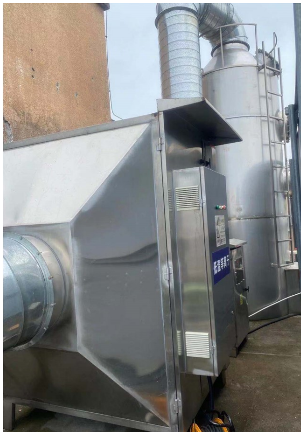
图 4.1-1 废气处理设施
