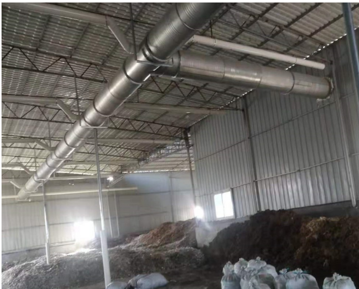
图 4.1-3 堆粪场废气收集系统
