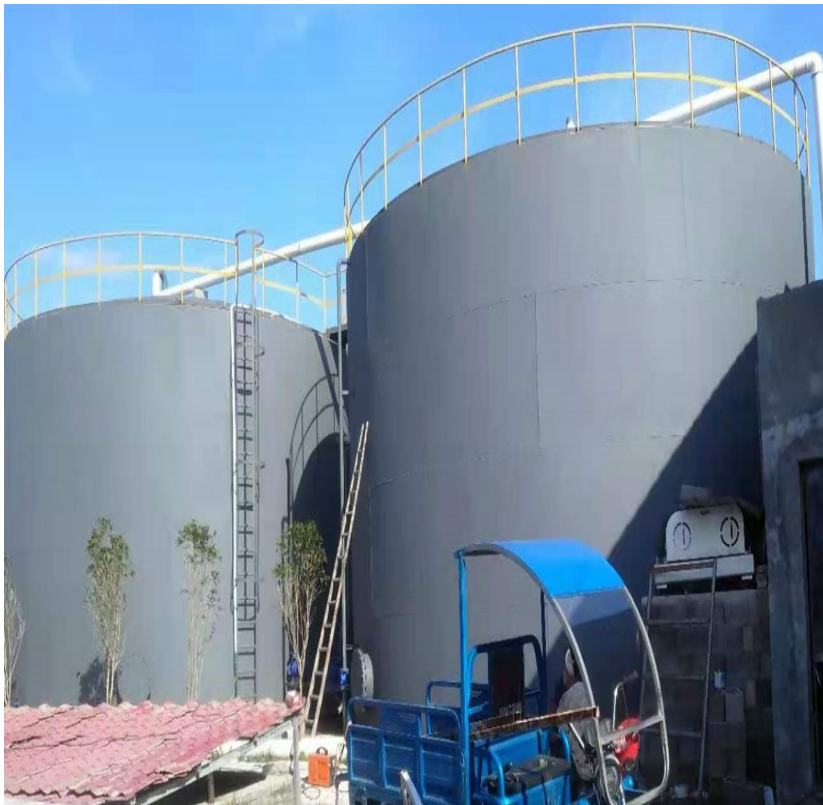
图 4.2-1 废水处理设施
