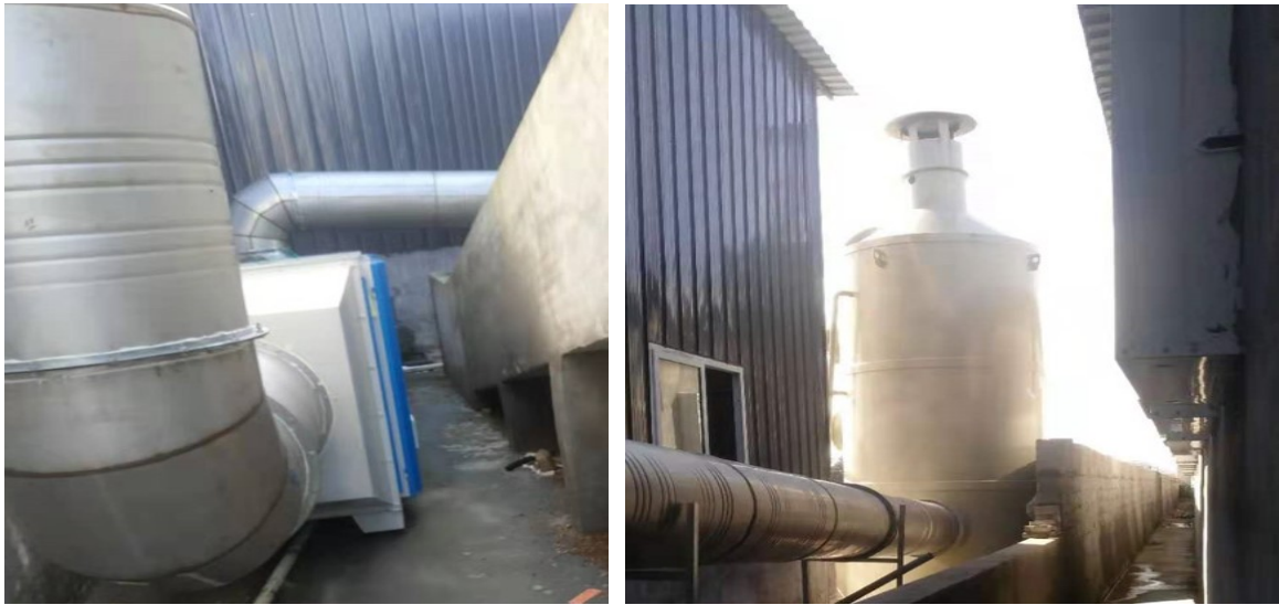
图 4.1-2 废气处理设施
