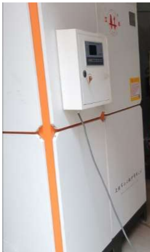
图 4.2-6 燃气蒸汽发生器
