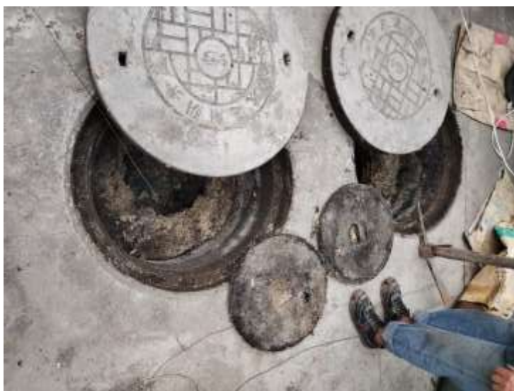
图 4.1-5 食堂废水隔油池
