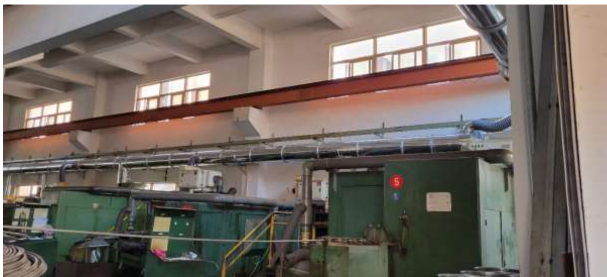
4.2-2 冷锻油雾车间内主管道
