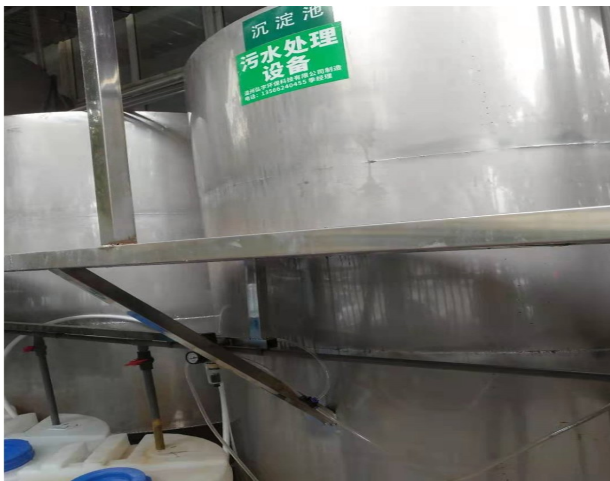
图 4.2-2 废水处理设施图
