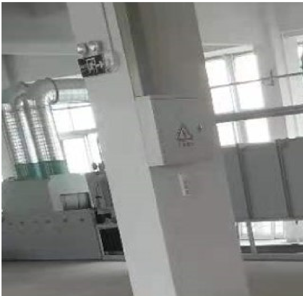
图 4.1-2 烘干废气排气筒
