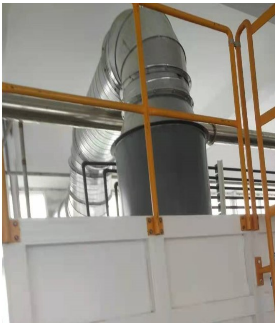
图 4.1-1 焊接烟尘排气筒
