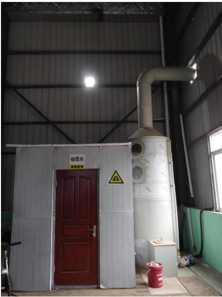
图 2.7.2-1 废气处理设施
