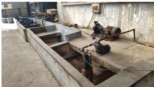
输乳化液管道
