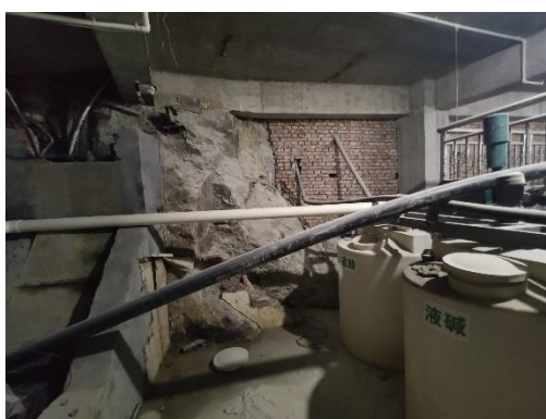
废水收集设施
