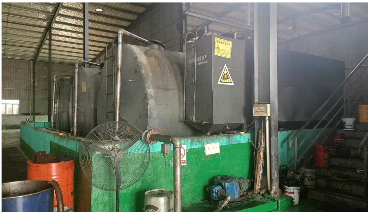
废矿物油装卸管道
