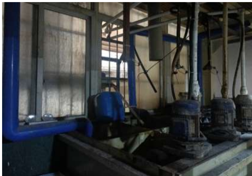
图 4.2-3 厂房内废水收集区内景
