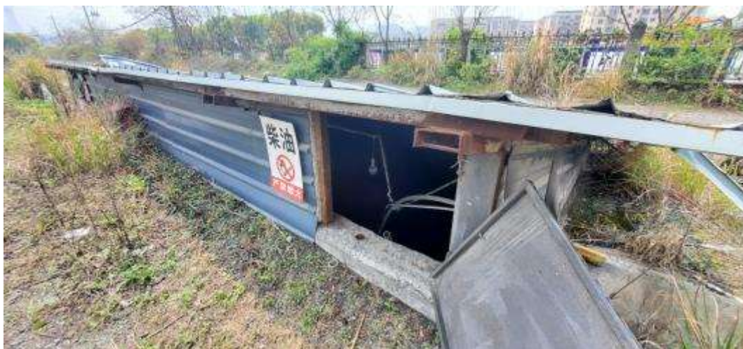
图 3.3-10 地下储罐（2021 年 03 月）
