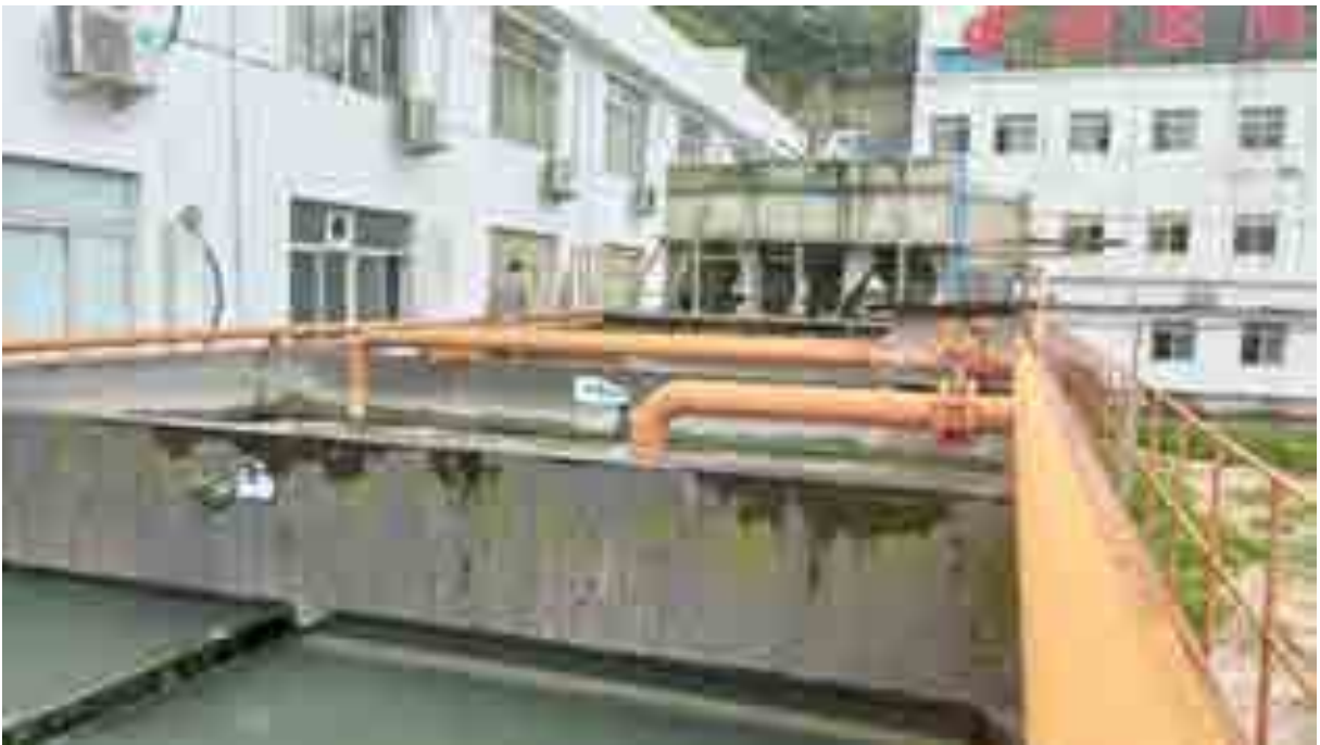
图 2.2-6 本单位废水处理站反应池
