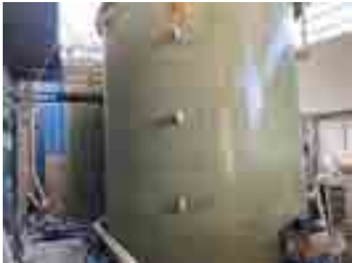
废水收集罐（玻璃钢）
