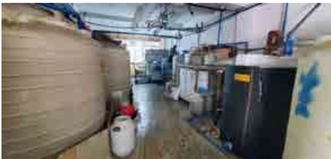
图 2.2-2 废水处理配药间、废水预处理间
