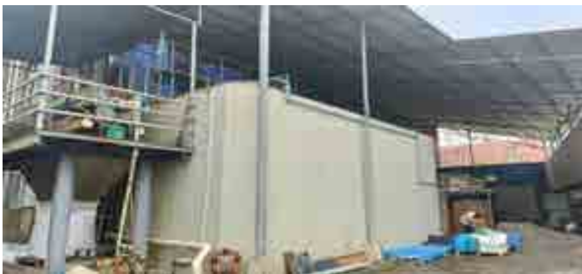
图 2.2-3 企业废水处理站
