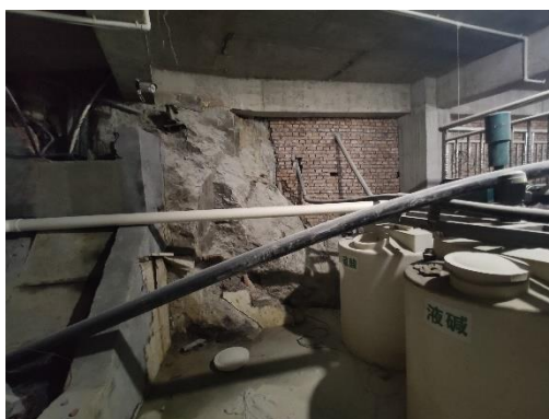
废水收集设施
