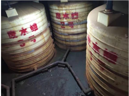
地下废水储罐
