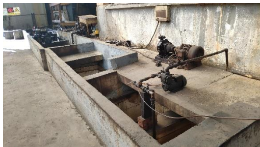
输乳化液管道
