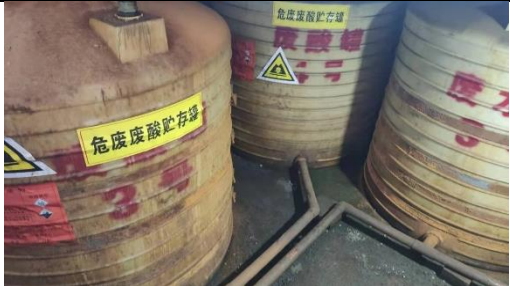
地下废酸储罐
