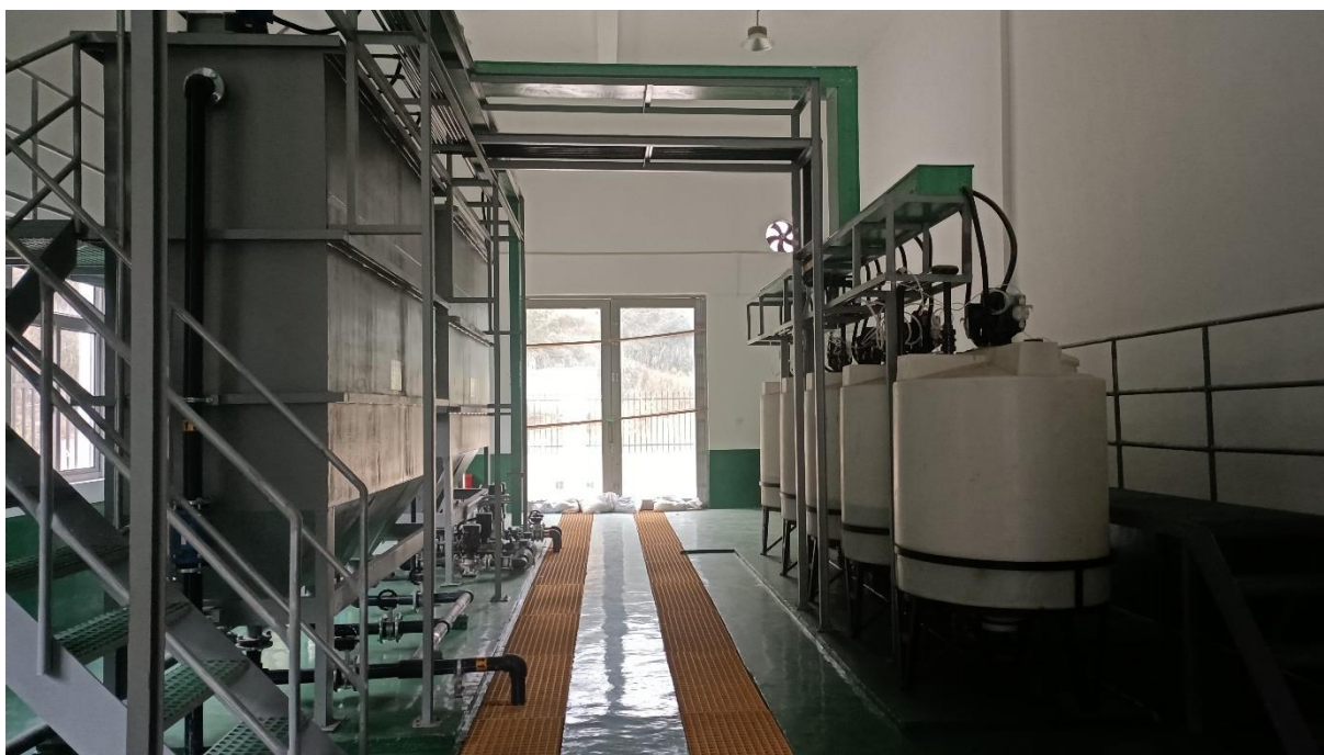
图 2.2-6 氧化还原絮凝槽与斜管沉淀池
