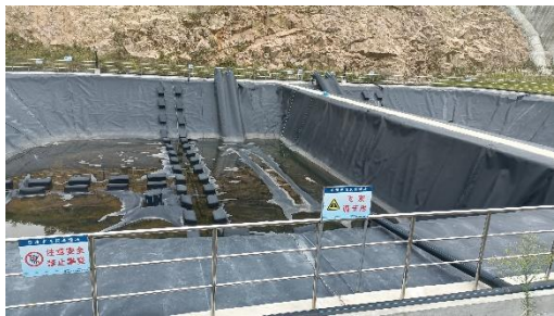
渗滤液调节池
