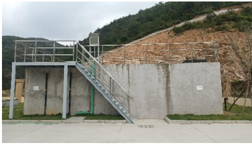
综合车间外地上清水池与浓缩液储池
