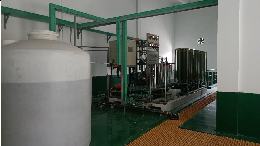
渗滤液管道走行于黄色网格板下，药水管为架空明管
