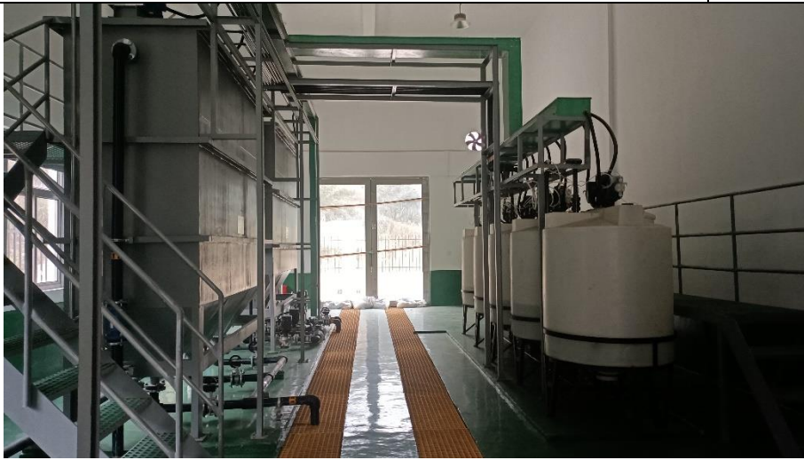
渗滤液处理站综合车间内药水储罐（右）
