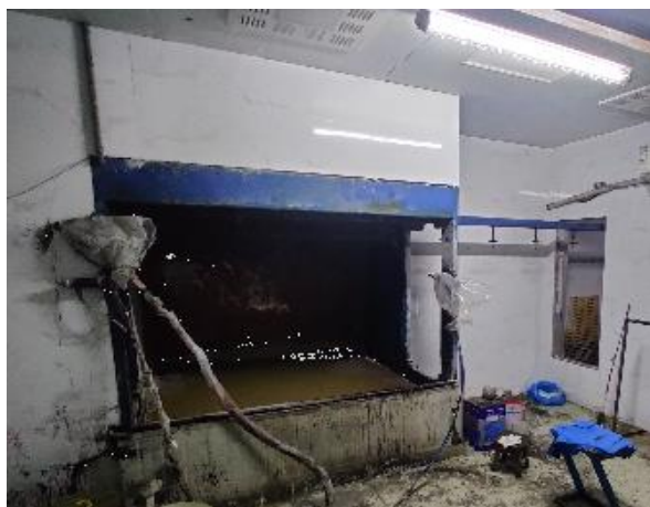
图 4.3-14 喷漆水帘喷台
