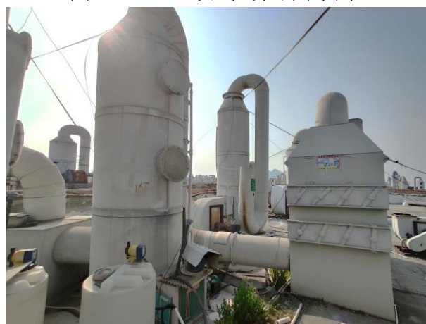
图 4.3-17 有机废气处理设施
