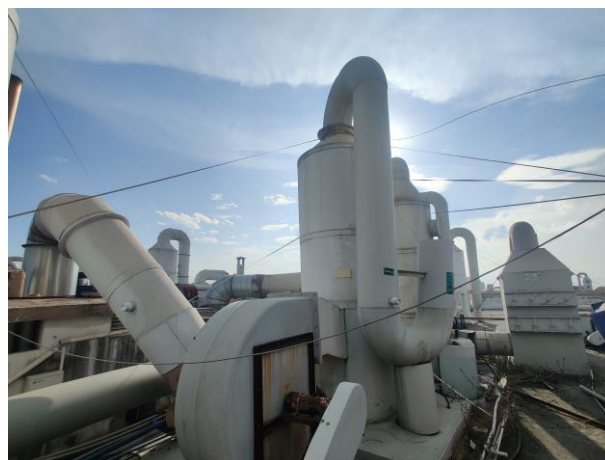
图 4.3-3 酸性废气处理设施
