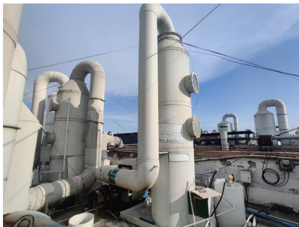
图 4.3-8 含氰废气处理设施（一级塔）
