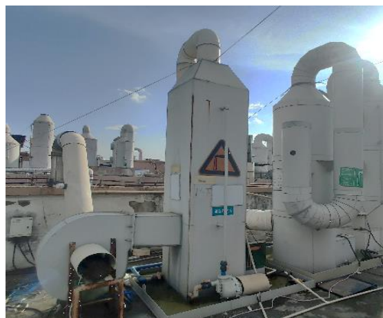
图 4.3-12 含铬废气处理设施
