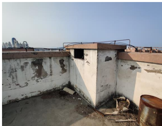
图 4.3-23 拉丝粉尘处理设施出口 2# (烟道出口)
