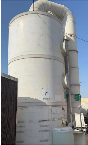
图 4.3-2 1 号综合酸雾废气处理设施
