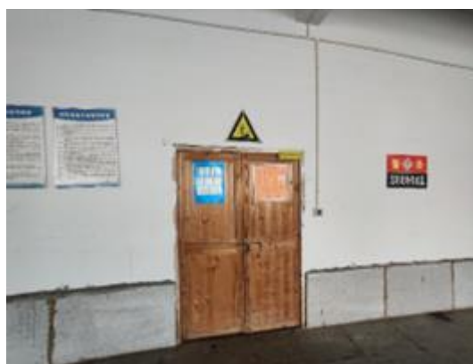
图 4.5-2 危废暂存中心 2
