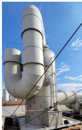
图 4.3-4 2 号综合酸雾废气处理设施
