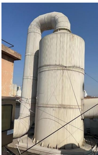
图 4.3-5 3 号综合酸雾废气处理设施
