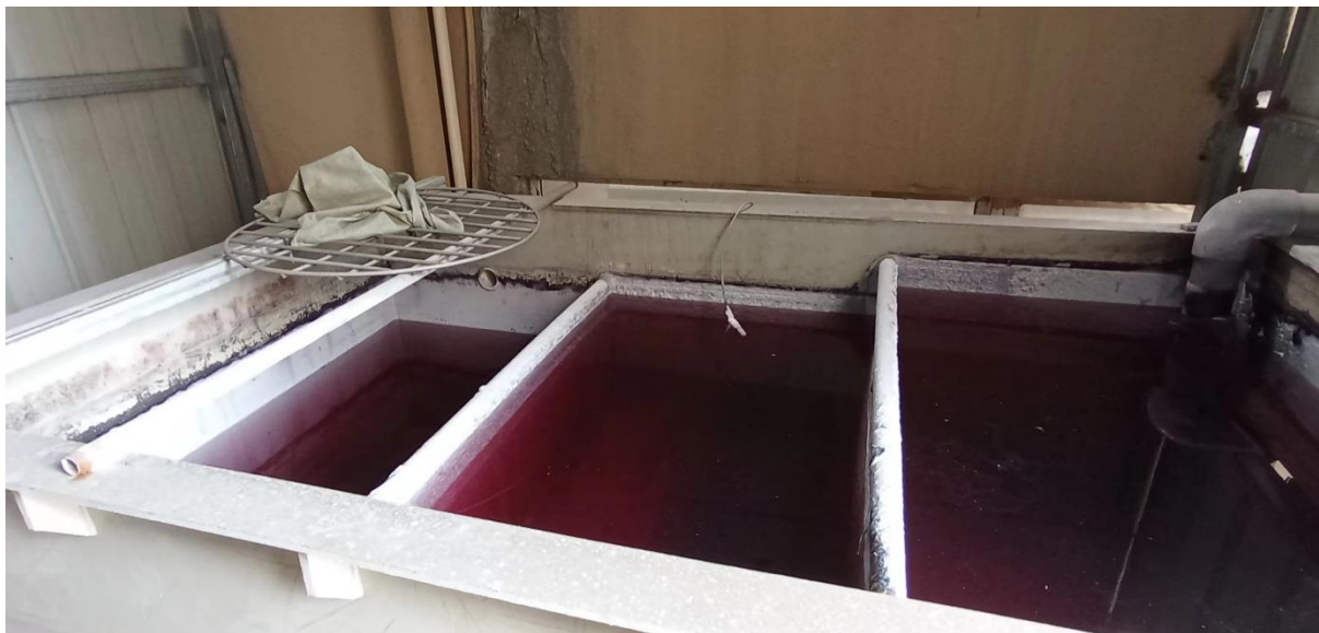
图 4.2-1 含磷废水预处理池
