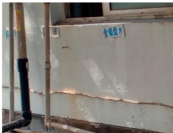
图 4.2-3 废水收集管道
