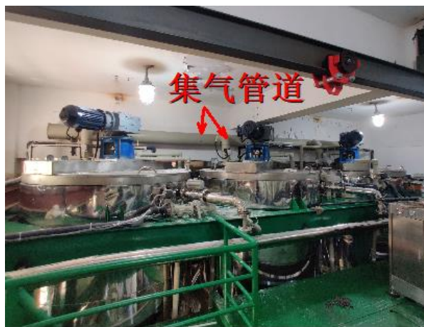
图 4.3-2 保温结晶釜及集气管道
