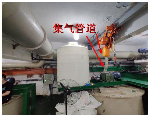
图 4.3-1 中和搅拌桶及集气管道
