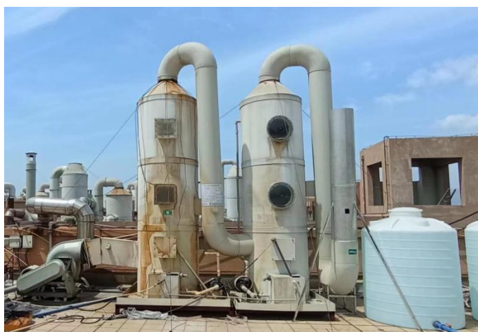
图 4.3-8 2 号含铬废气处理设施
