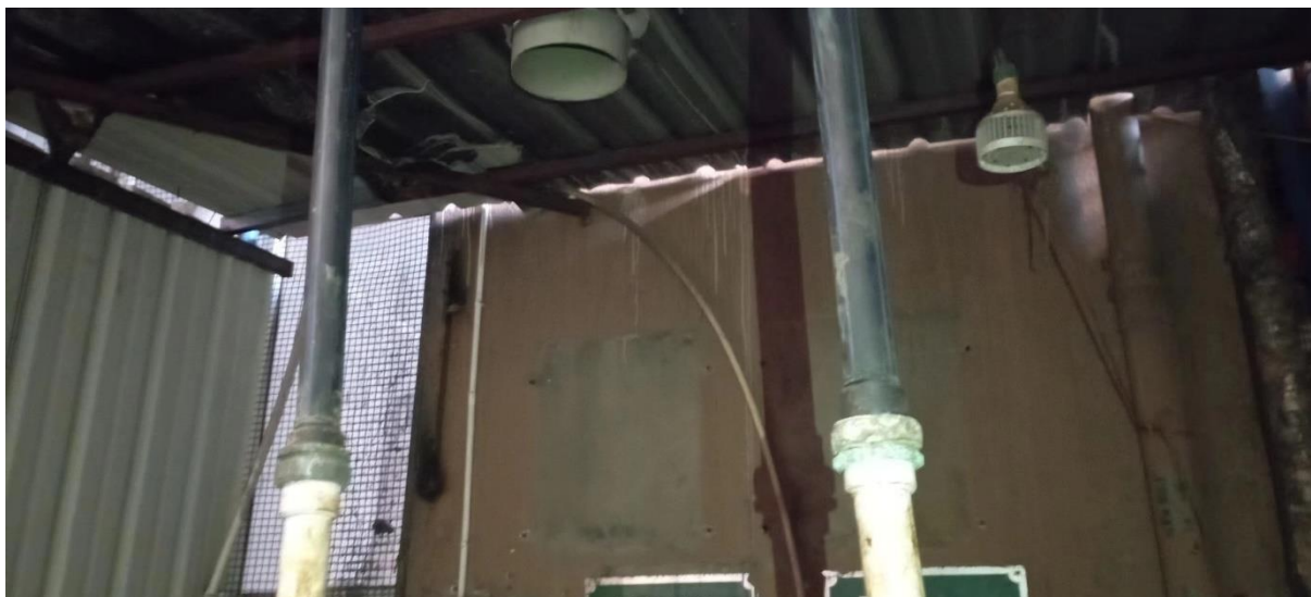
图 4.3-9 收集池废气集气口
