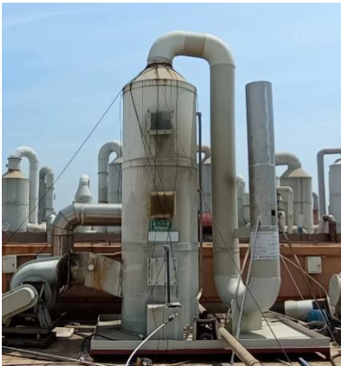
图 4.3-2 1 号综合废气处理设施
