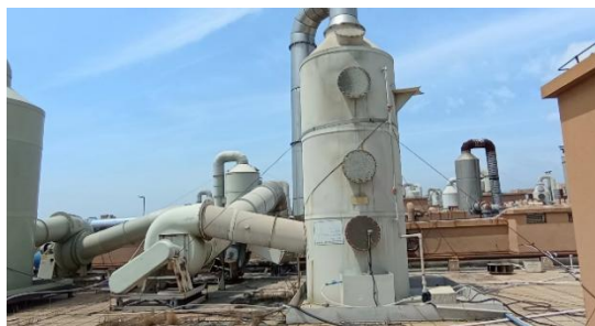
图 4.3-6 3 号综合废气处理设施
