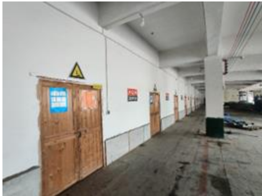
图 4.5-1 危废暂存中心 1
