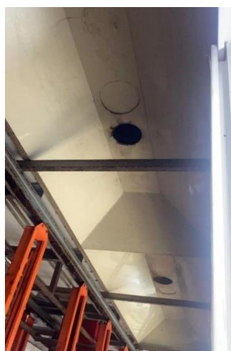
图 4.3-7 镀铬槽集气口
